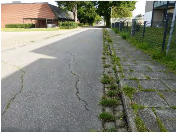
Spitzenkamp – schadhafter Zustand
