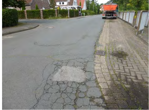
Eichendorffweg – schadhafter Zustand
