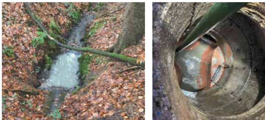
verschmutztes Wasser im Graben und im RW-Kanal
