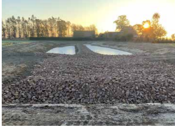
Mühlendamm – Regenrückhaltebecken mit Strömungstrenner und Notüberlauf (November 2022)
