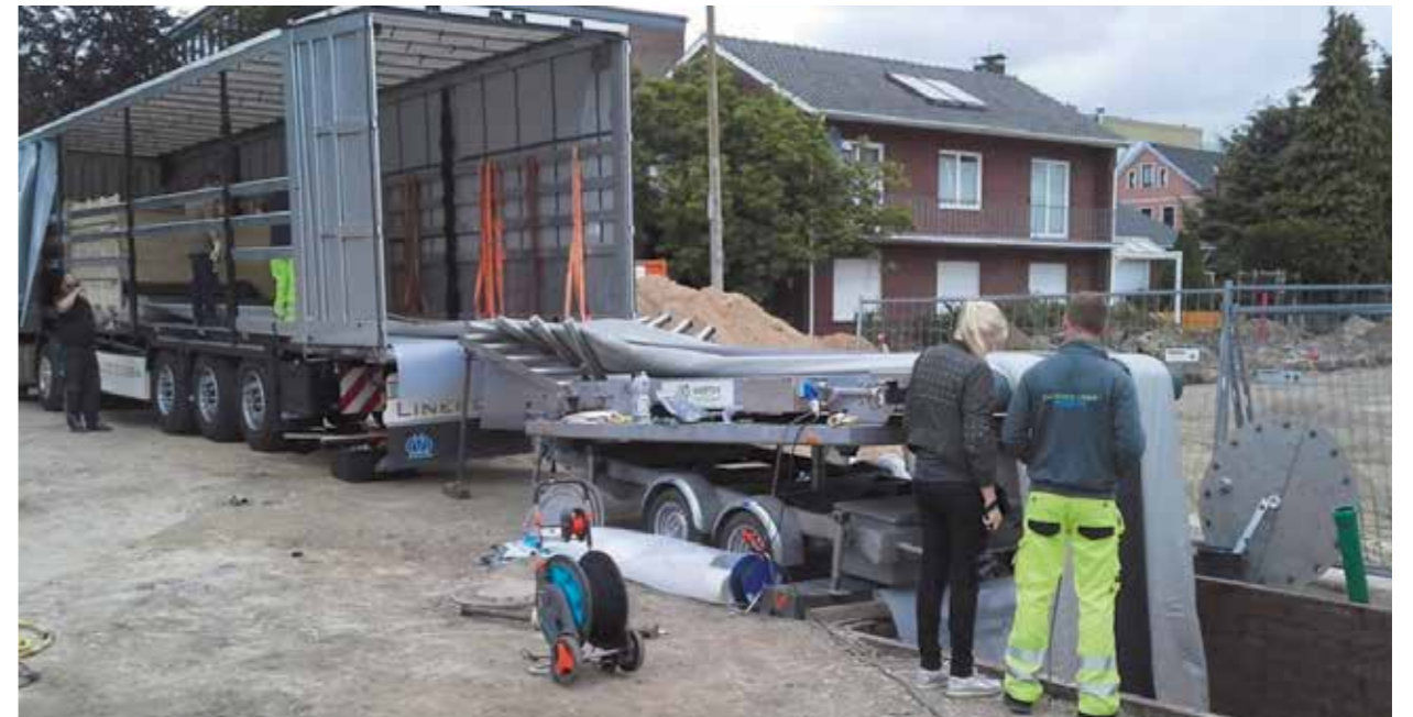
Vom Lkw direkt in das Kanalrohr: Mitarbeiter einer Kanalbaufirma ziehen den Gewebeschlach in den sanierungsbedürftigen Regenwasserkanal.
