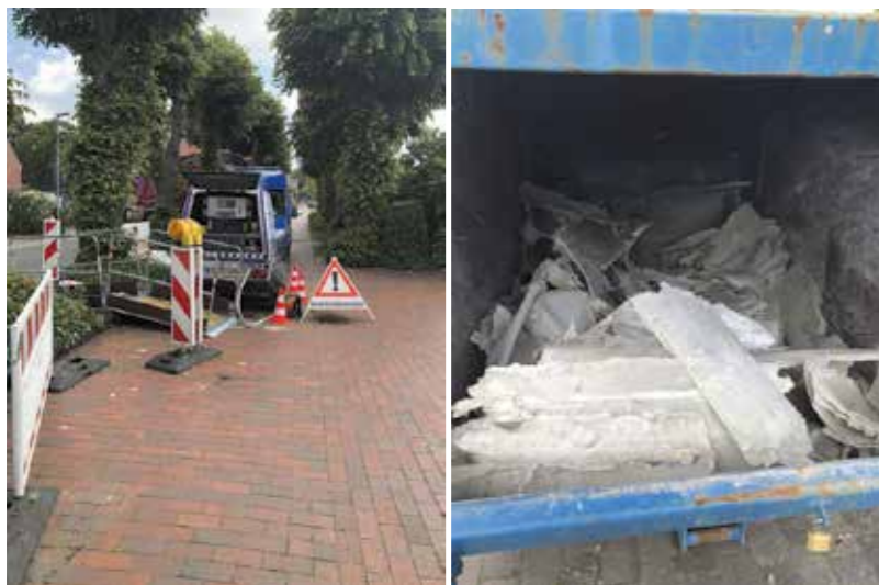
Entfernen des Inliners mittels Höchstdruckwasserstrahl (Bild links) und Entsorgung im Container (Bild rechts)
