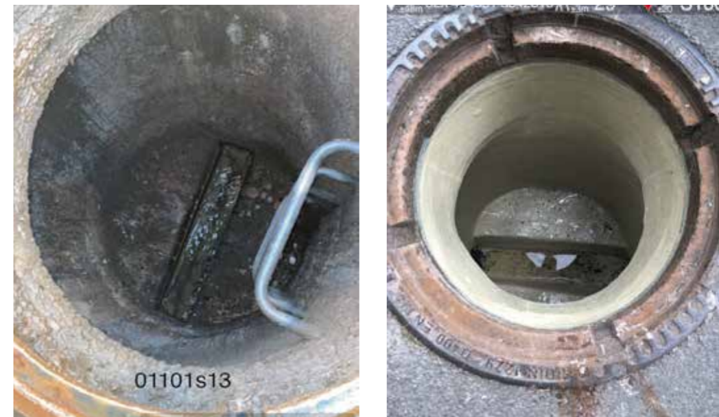
Schädigung der Schmutzwasserschächte durch Schwefelsäure vor der Sanierung (linkes Bild) und sanierter Schacht (rechtes Bild)
