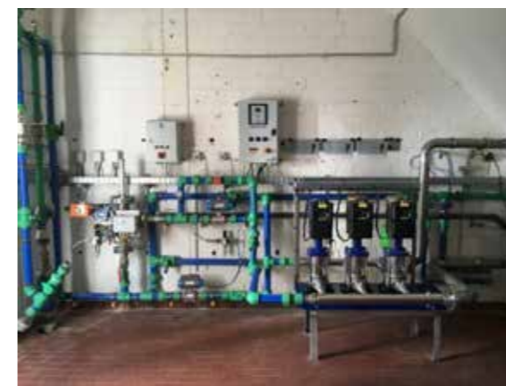
Bild: Überarbeitete Brauchwasseraufbereitung
