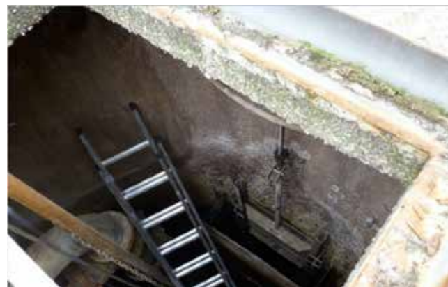
Durch Betonkorrosion geschädigter Zulaufschacht
