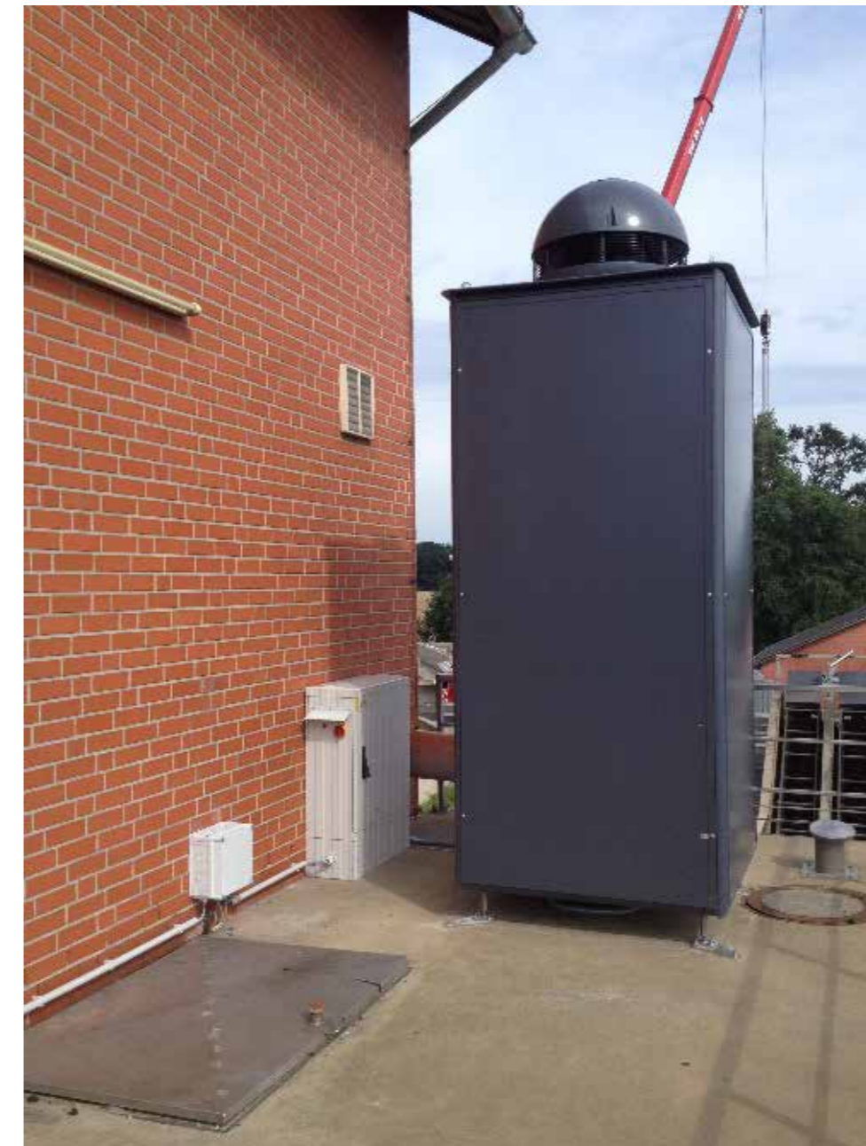
Volumenanfall gesteuerter Abluftfilter am Rechengebäude
