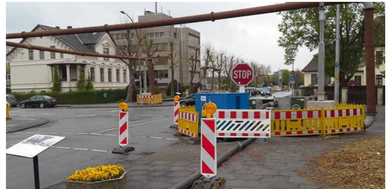
Abwasserüberleitung mit Hilfe einer Rohrbrücke aus Stahl
