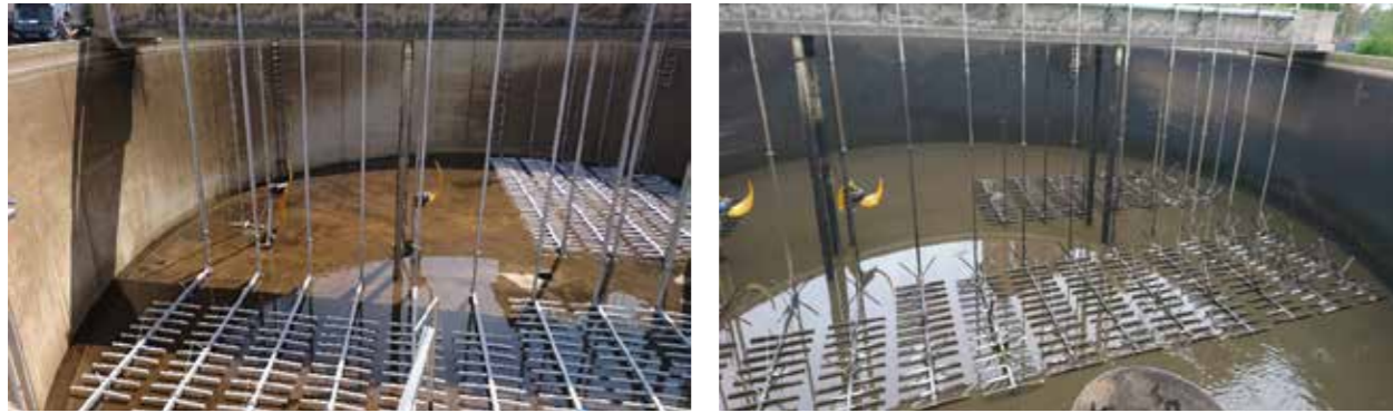
links nach der Außerbetriebnahme, rechts die fast verdoppelte Anzahl der Belüftergitter nach der Neuausrüstung
