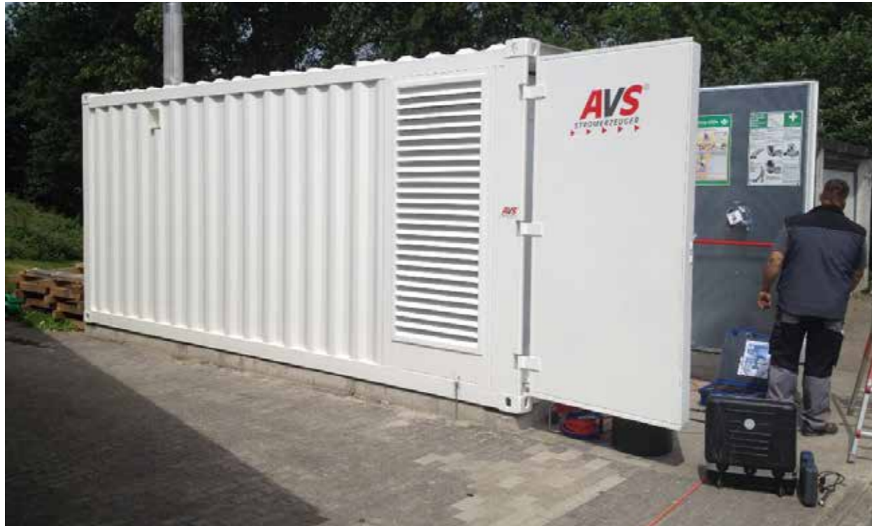
Kompakte Notstromversorgungseinheit (500 kVA) im 20-Fuß-Container bei der Inbetriebnahme
